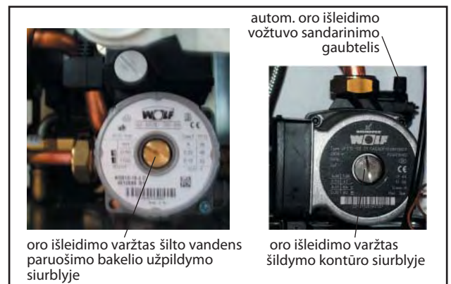
Pav. Oras pašalinamas visų pirma iš šildymo kontūrė siurblio, po to iš šilto vandens paruošimo bakelio užpildymo siurblio
