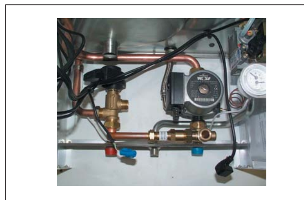
Pav. Prietaisas, išėmus šilto vandens paruošimo kontūrą
